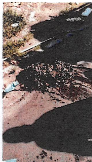
Excesso de sujeira
