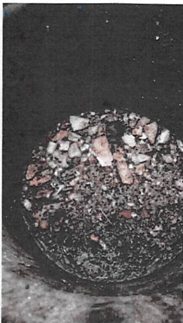
Entulho dentro do PV
