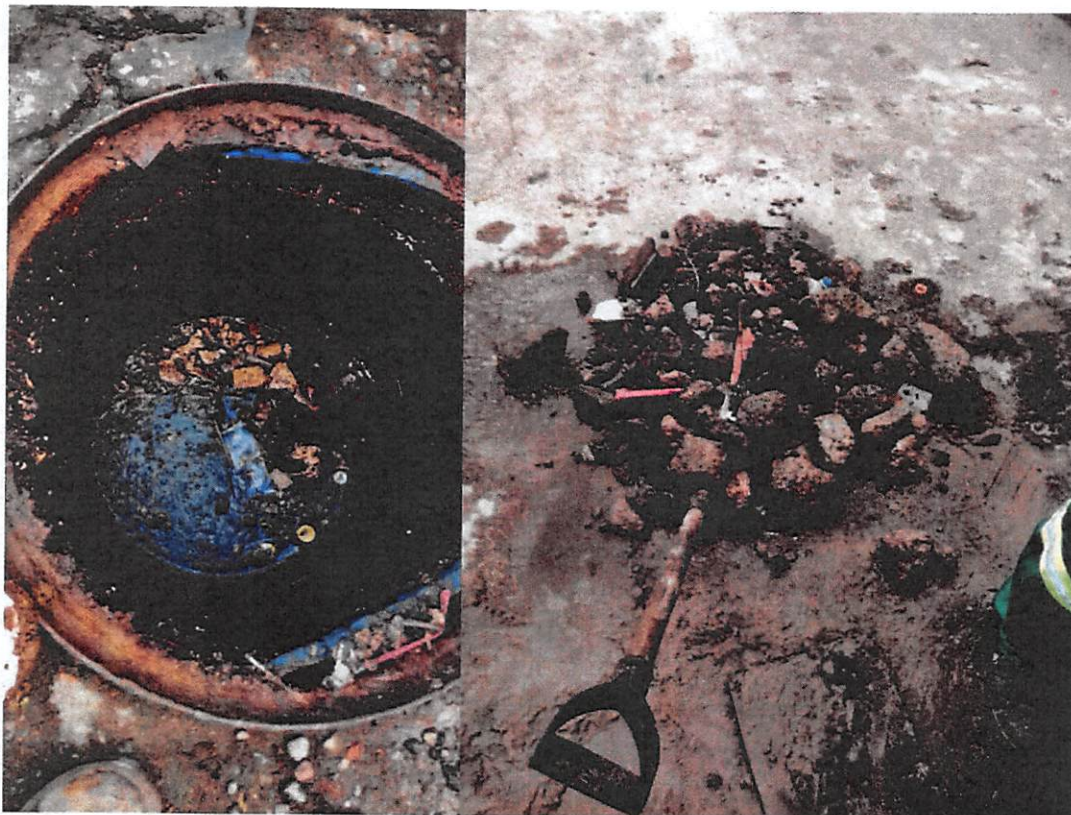
Descarte irregular de material plástico e entulho no PV
