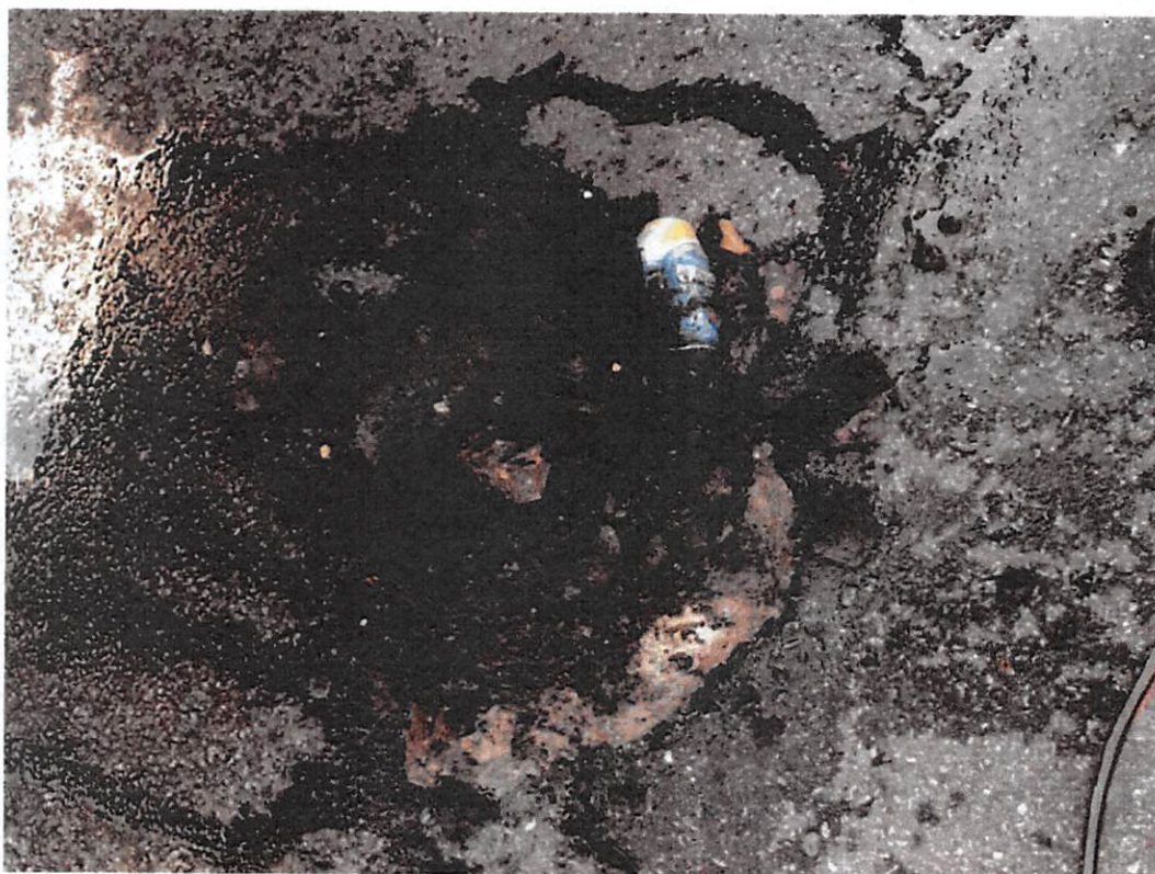
Excesso de sujeira retirada do PV (entulho, latinha, lixo) durante desobstrução de rede
