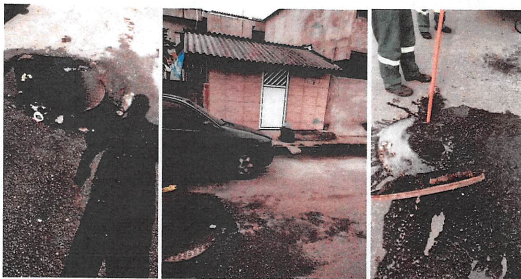
Extravasamento de rede causados por obstrução devido excesso de sujeira no sistema
