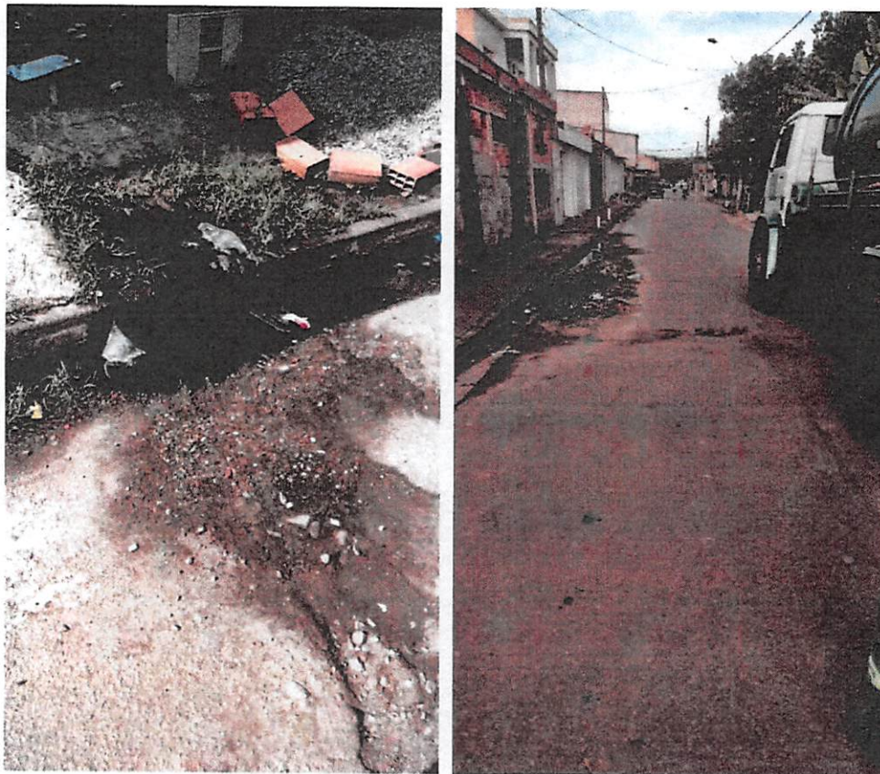
Extravasamento de ramal causados por obstrução devido excesso de sujeira no sistema
