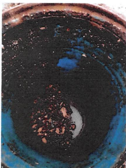
Excesso de sujeira e entulho dentro do PV
