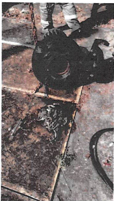
Entupimento de Bomba
